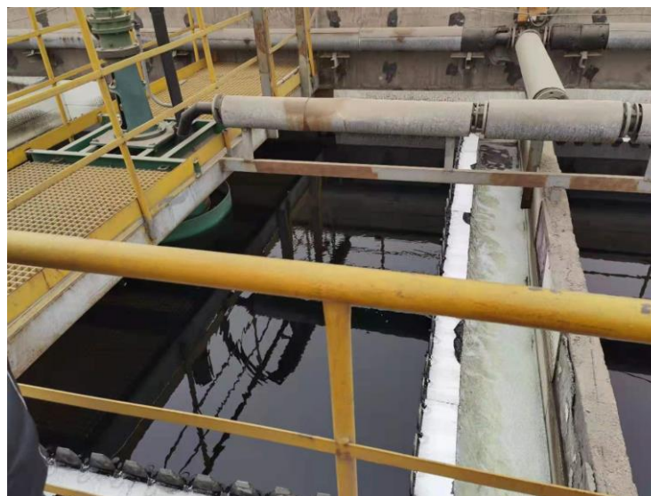
园区污水处理厂
