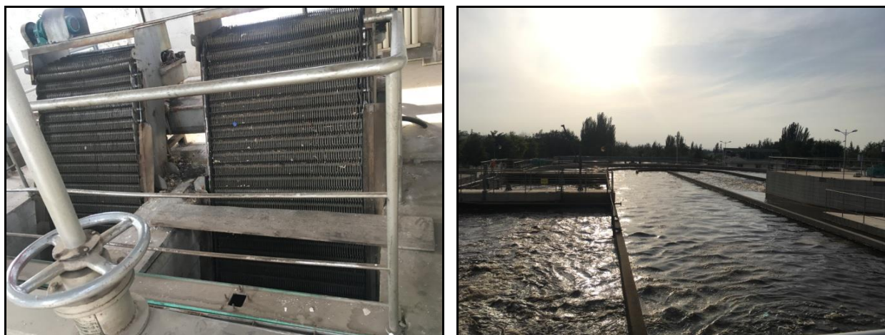
图 7-5 乌海市海勃湾区污水处理厂现状实景照片
